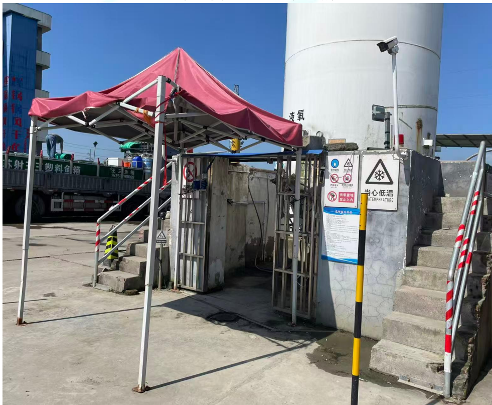
储罐区东侧安全标识、人体静电释放器、静电接地
