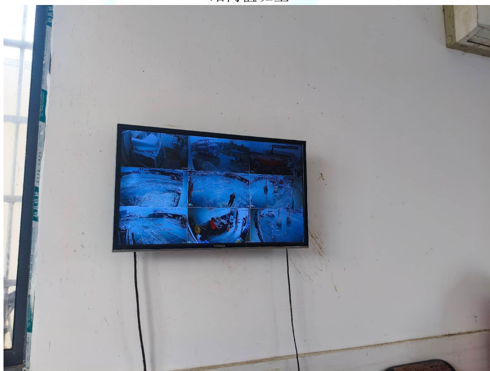
值班室内视频监控
