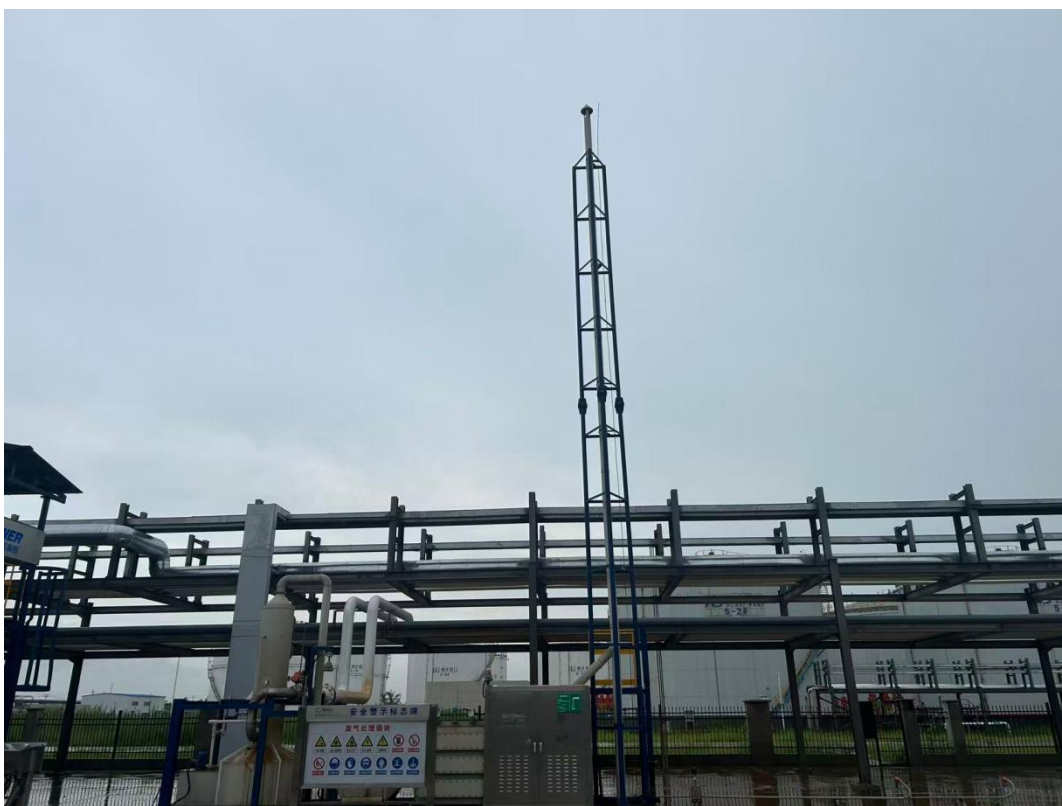
酸性废气处理设施
