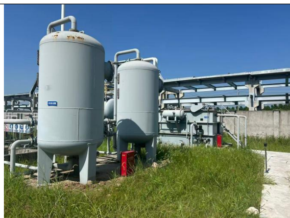
污水处理装置
