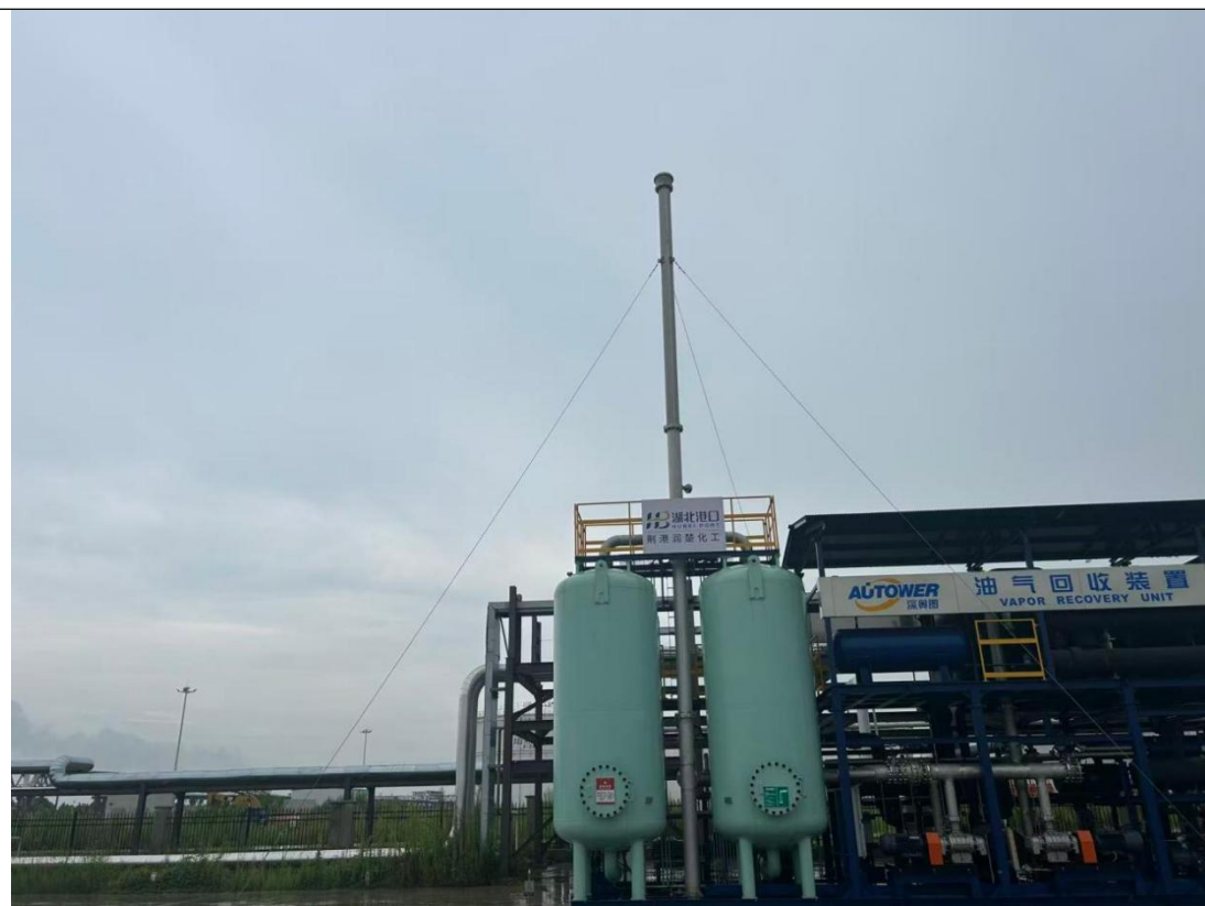
高浓度 VOCS 处理设施
