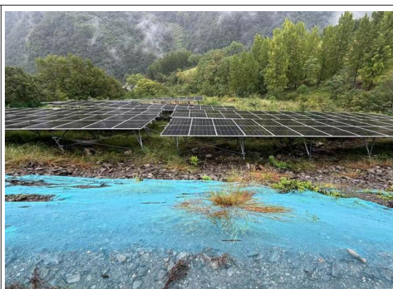
光伏区防护网
